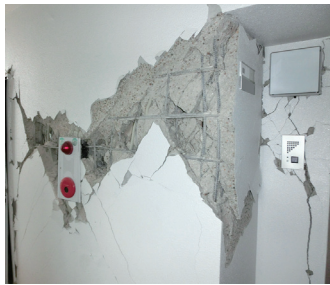
熊本地震で壁が壊れ、ドアが歪んだ熊本市内のマンション。住民は建て替えを覚悟していた。
